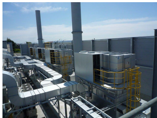
蓄熱燃焼式排ガス処理装置
