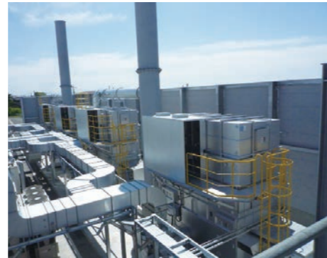
蓄熱燃焼式排ガス処理装置
