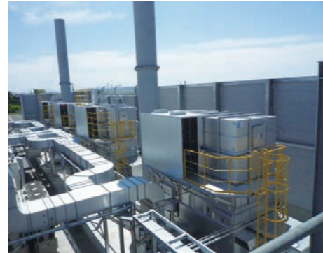
蓄熱燃焼式排ガス処理装置
